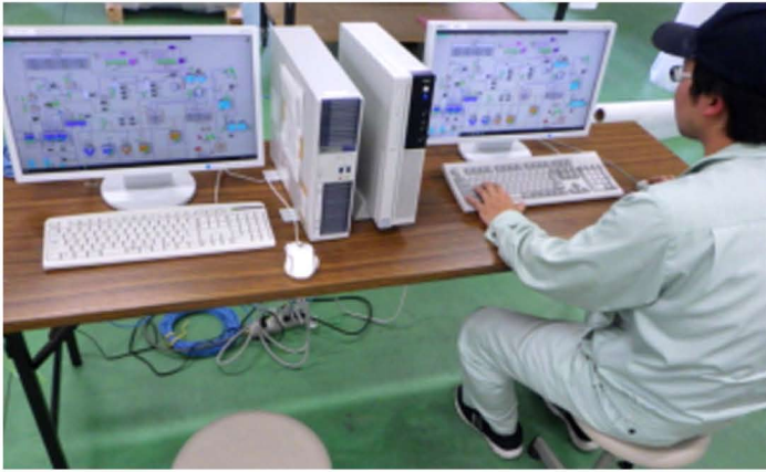
中央監視装置
