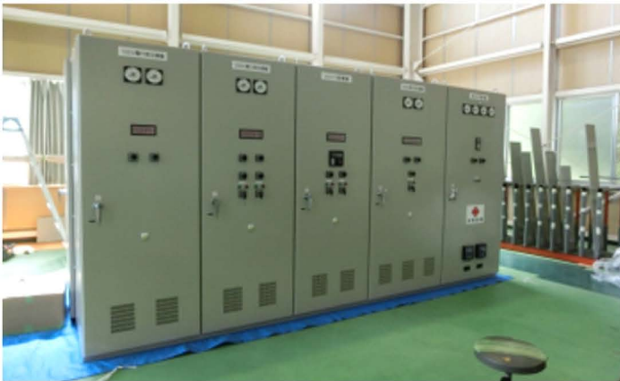
高圧受変電盤
