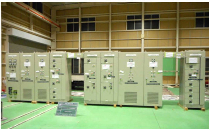
コントロールセンター
