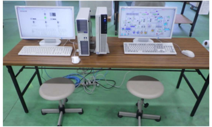
中央監視装置
